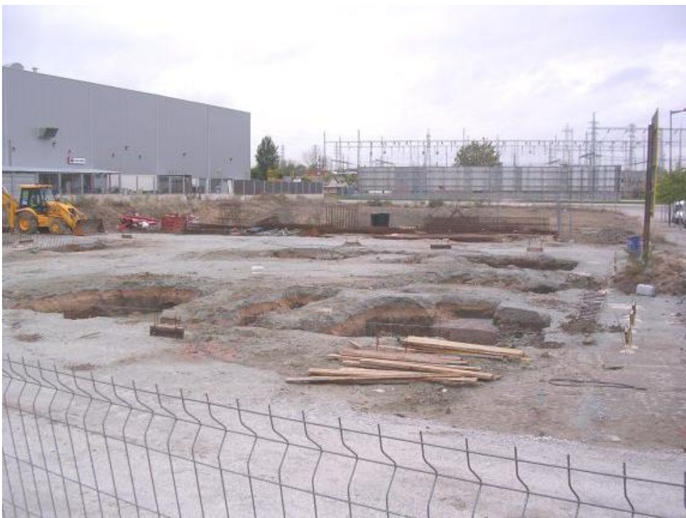
Sobre la parcela, excavación de los pozos para la cimentación. Octubre de 2006
